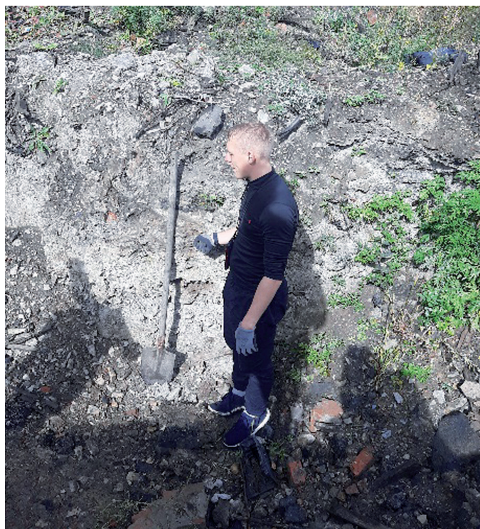
Рис. 6. Измерение глубины выкопанной траншеи при несанкционированной выемке коммуникаций (около 1,7 м) (фото авторов)
